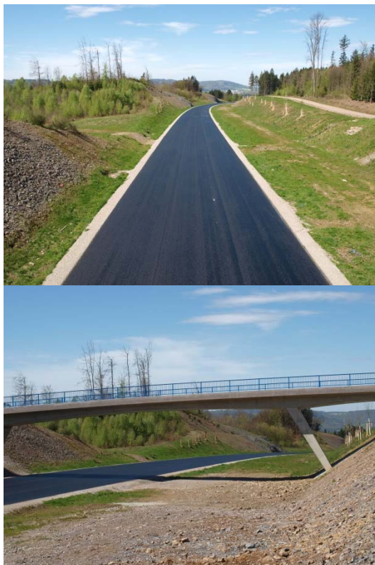
Abbildung 10: Fotos zu längsgeteilte Dringlichkeit (1. Fahrbahn) im Abschnitt A 98.7
