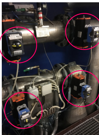
„neue“ automatische Filterklappen
