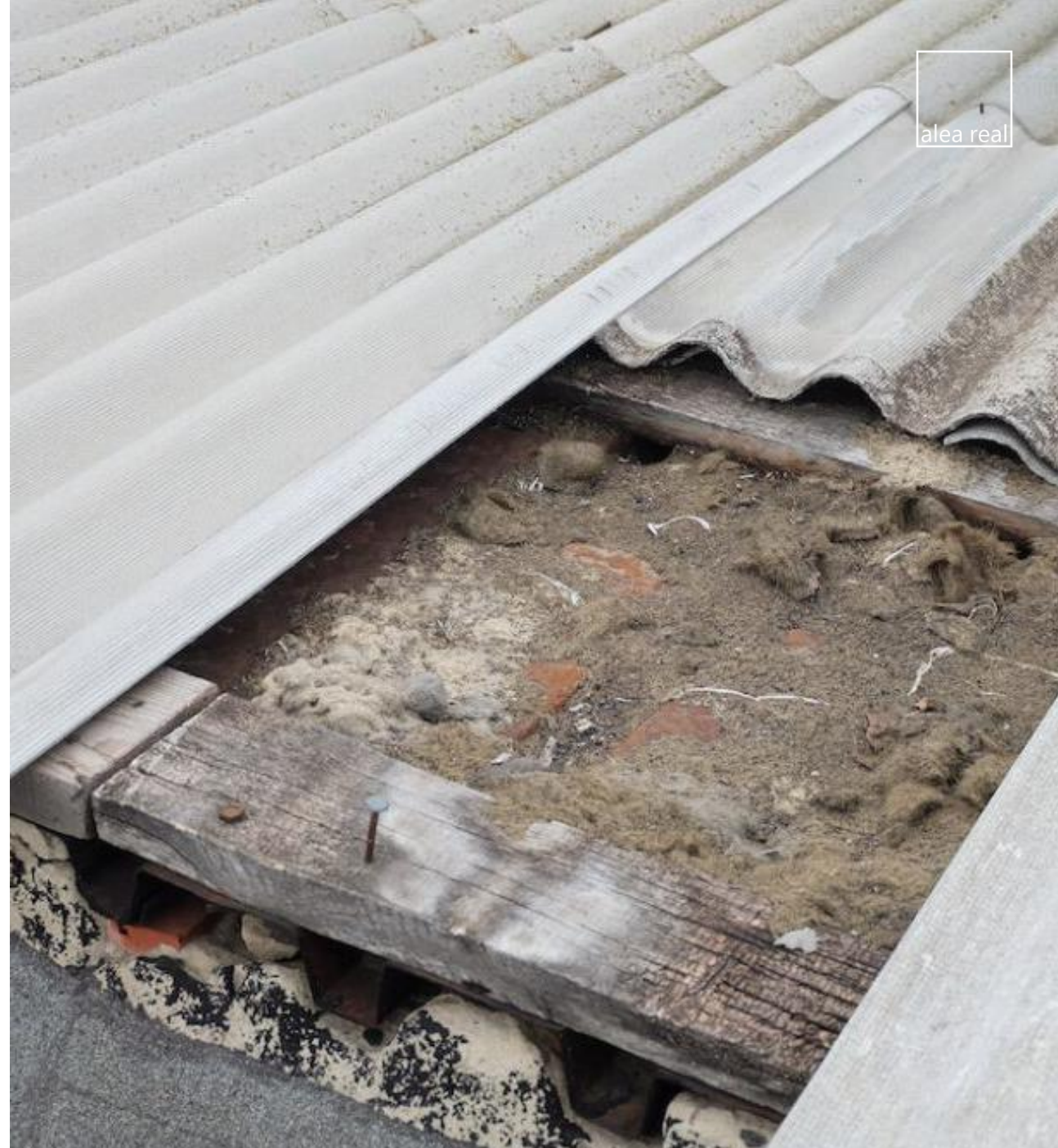
Beispielfoto, da keine Bauteilöffnungen stattgefunden haben. Schadstoffe statistisch Baujahresbedingt.
